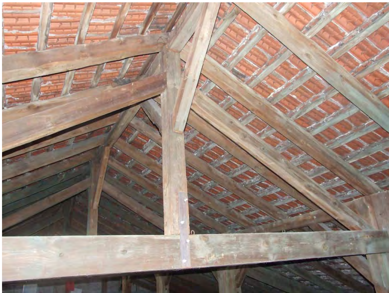
Zdjęcie nr 3. Widok górnej części wiązara wieszarowego. Widać rozporę poziomą podwieszoną do wieszaka w płaszczyźnie kalenicy, górne rozpory i płatew kalenicową z mieczami. Podwieszenie rozpory za pomocą płaskowników, wykonane podczas poprzednich remontów.
