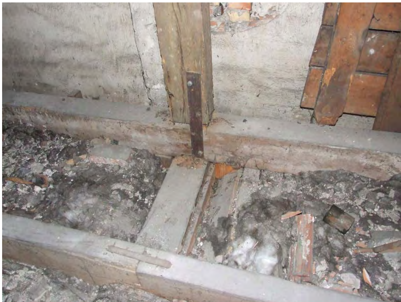
Zdjęcie nr 8. Skrajny wiązár wieszarowy przy ścianie szczytowej. Widać podwieszenie belki-pasa dolnego do pojedynczego wieszaka , wykonane w trakcie poprzednich remontów. Odsłonięte podbicie sufitu z desek i wierzch pociągu 30x30 opartego w tym miejscu na ścianie szczytowej. Belka stropowa pośrednia łączona na podciągu.
