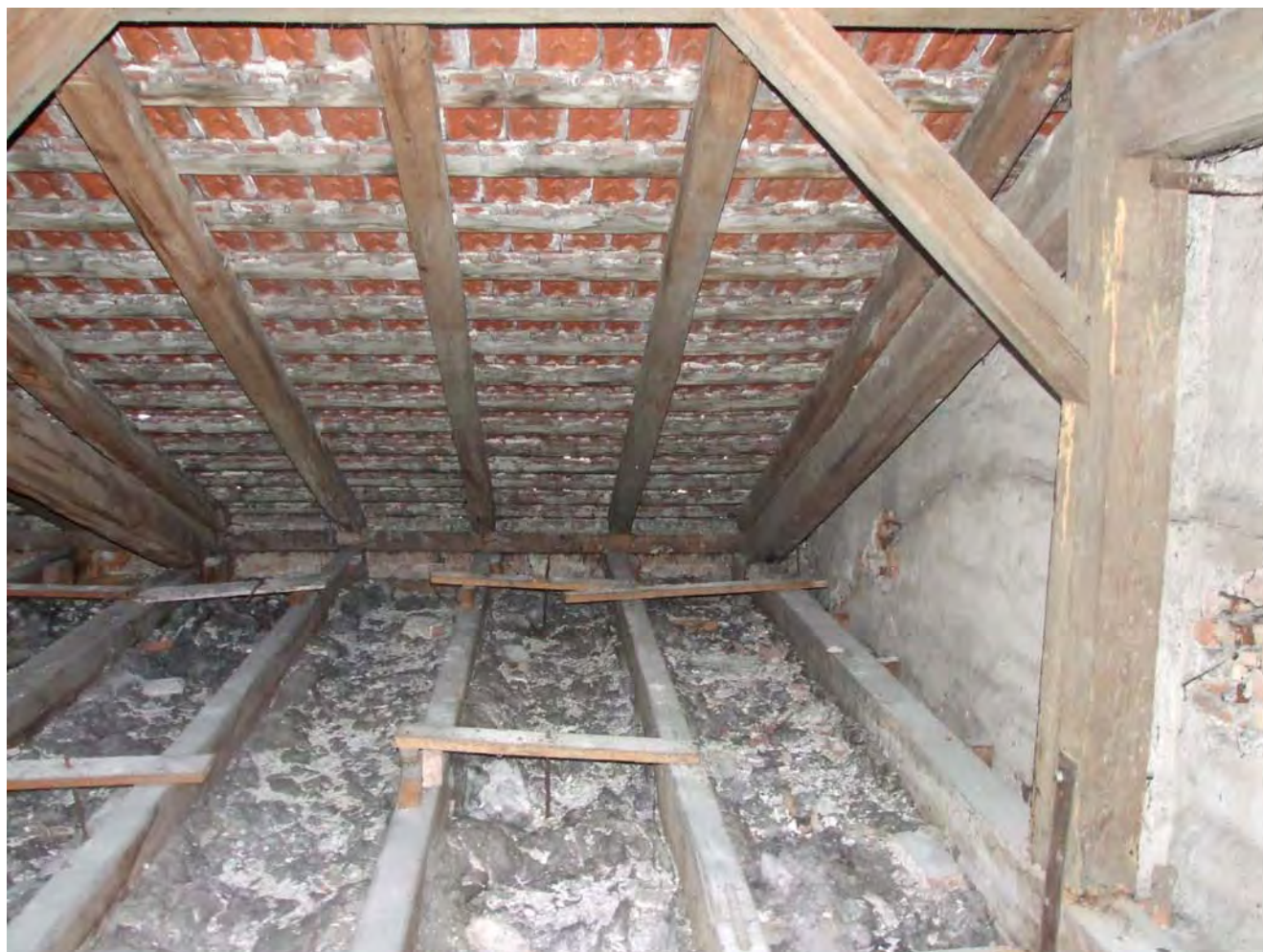
Zdjęcie nr 5. Wiązar wieszarowy od strony ściany szczytowej. Wiązary skrajne posiadają pojedyncze wieszaki. Widać deski leżące poprzecznie na belkach stropu, do których podwieszono wieszaki podwieszono sufitu modułowego.
