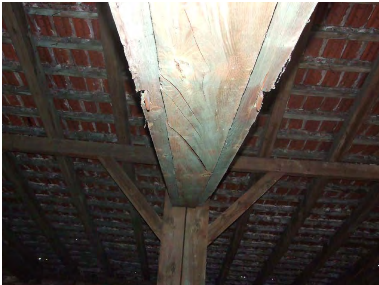
Zdjęcie nr 2. Widok rozpory z poprzedniego zdjęcia od spodu. Widać uszkodzenie przez pęknięcie . Rozporę należy wymienić.
