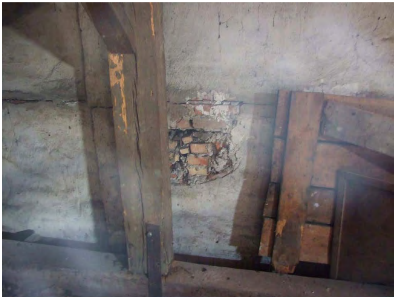
Zdjęcie nr 9. Wieszak skrajnego wiązara wieszarowego – widać pod mieczem korozję biologiczną drewna.
