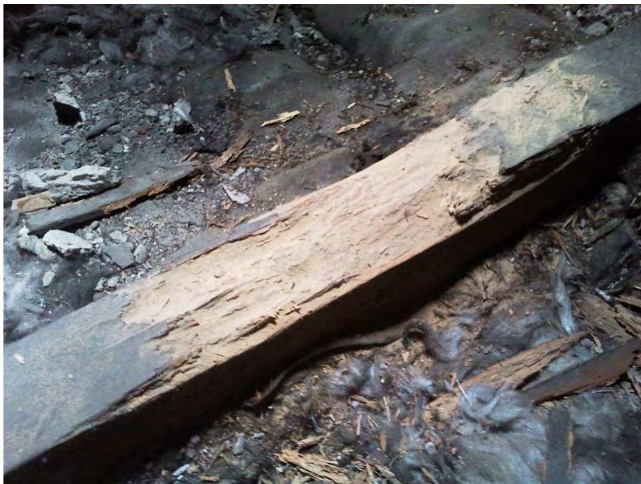
Zdjęcie nr 12. Silna korozja biologiczna belki pośredniej.
